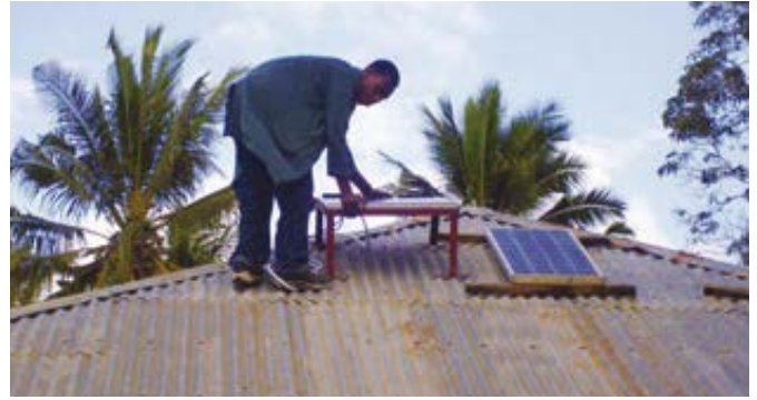
Installation einer Solaranlage zur Elektrifizierung einer Kranken- und Entbindungsstation in Tansania, Partnerschaftsausschuss Schlüchtern - Ev. - Luth. Maneromango District.
